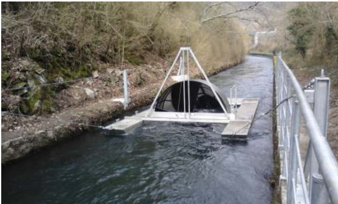
"Sistema RST" instalado en el canal
