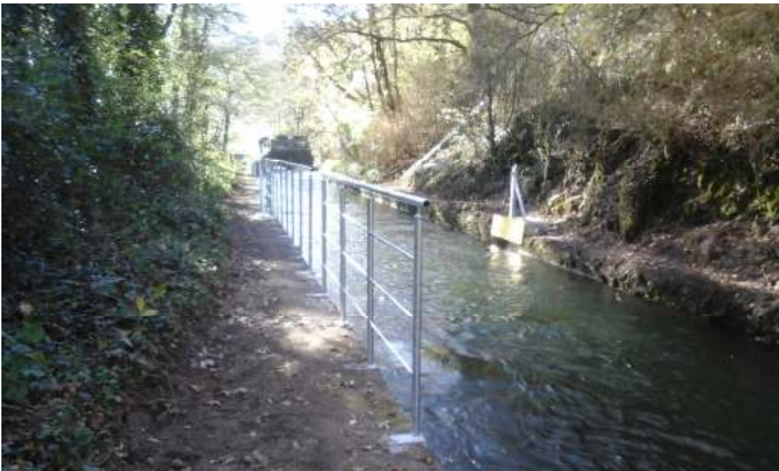
Barandilla zona ubicación RST y sendero paralelo canal
