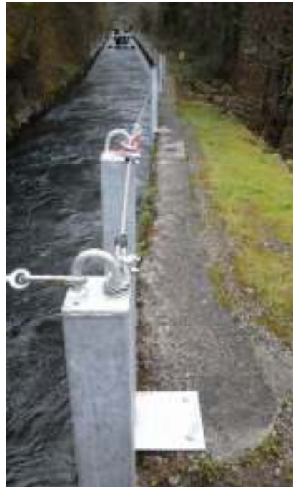
Aspecto línea de anclaje horizontal
